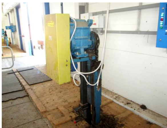
Рис. 27 – Общий вид станции приводной вертикальной транспортёра ТСГ-170
