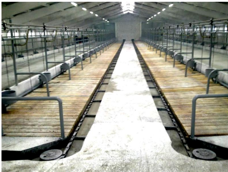
Рис. 18 – Общий вид горизонтального транспортера КСН-Ф-100, установленного на ферме
