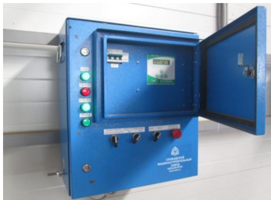
Рис. 29– Общий вид шкафа управления АСУ-Т1 транспортёра ТСГ-170
